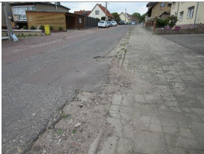
Sanierungsbedarf Könnernsche Straße einschl. Gehewege
