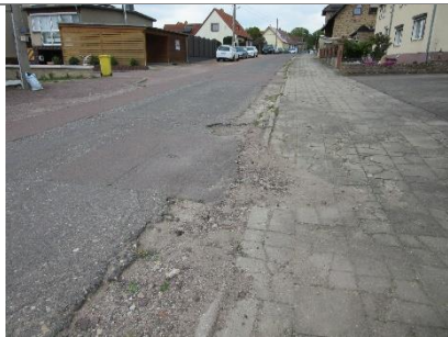
Sanierungsbedarf Könnernsche Straße einschl. Gehewege
